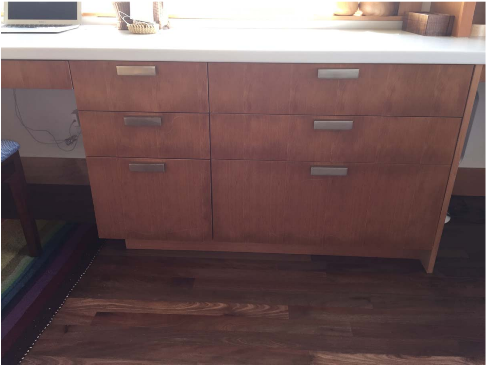
Photo 09 Cabinets.JPG (3264x2448x16M jpeg)
